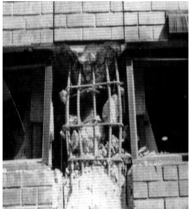
Figura 1.1.3.2 – Rottura a taglio del pilastro per tamponature parziali in altezza
